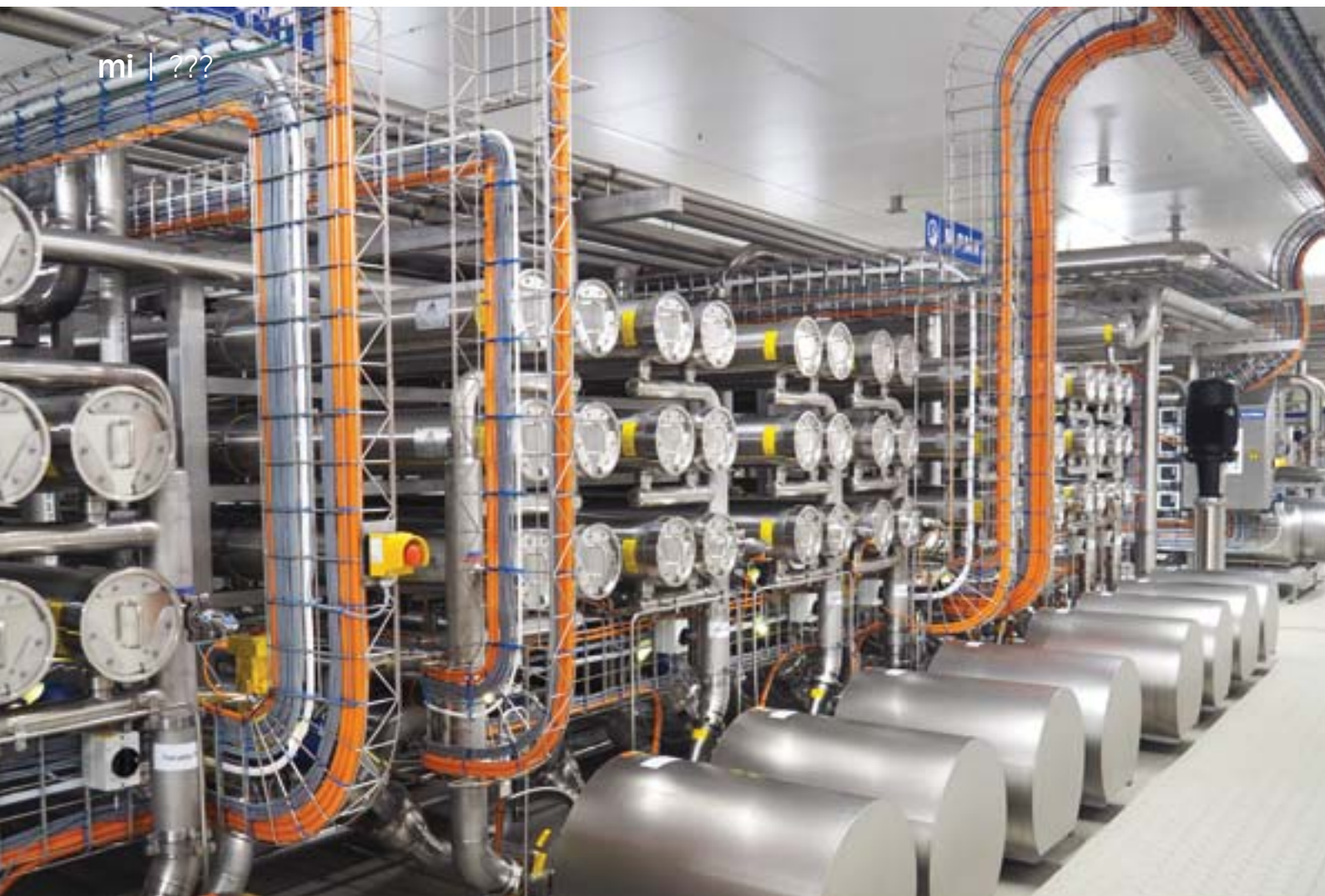
Die UO-Anlage ALPMA RO High in Gerkesklooster hat eine Membranfläche von über 10.000 m 2 (Foto: mi)
