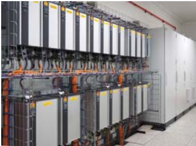
Die Automation wurde an den niederländischen Spezialisten Beenen vergeben (Foto: mi)
