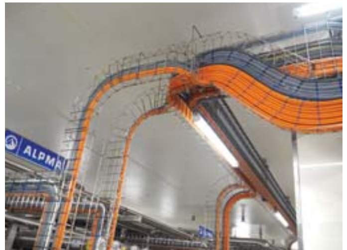
Ein Blick auf die Verdrahtung zeigt, wie viel Sorgfalt bei der Installation der Anlage aufgewendet wurde (Foto: mi)
